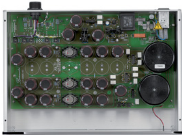
Ein Blick ins Netzteil: Die beiden gekapselten Ringkern-Transformatoren und die Gesamtkapazität von 60 000 Mikrofarad reichten auch für einen Vollverstärker
